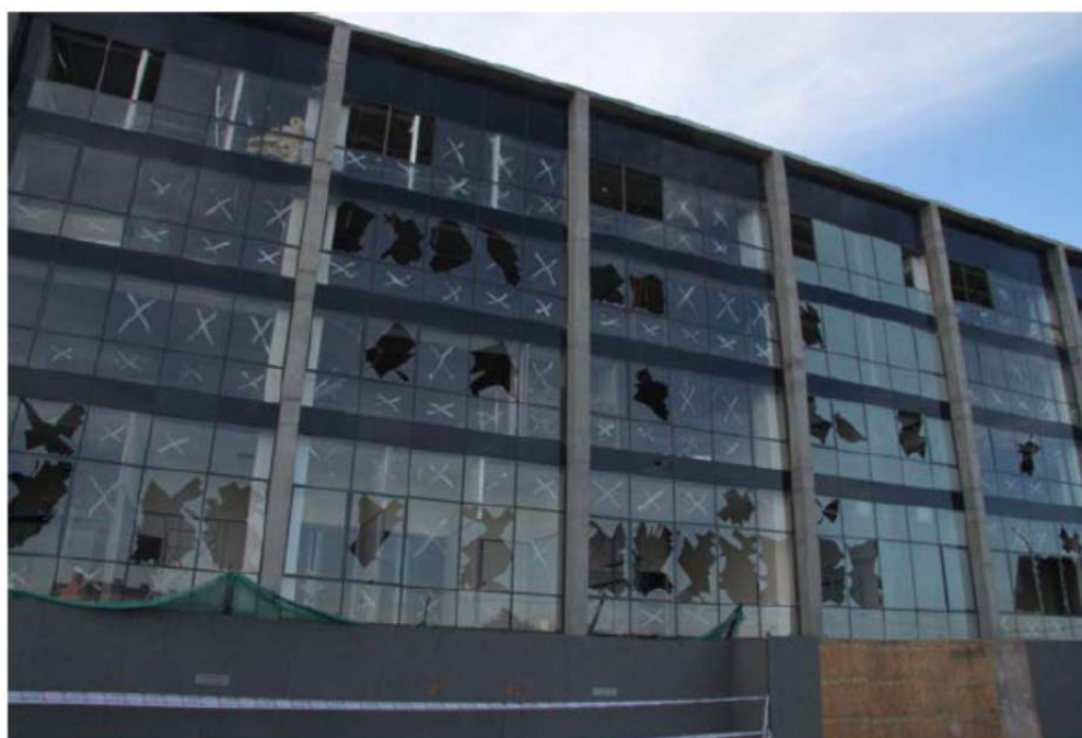
شکل پ ۲-۱- آسیب وارده به نماهای شیشه‌ای در بیمارستان واقع در مرکز شیلی در زلزله ۲۰۱۰ شیلی، بزرگا ۸/۸
