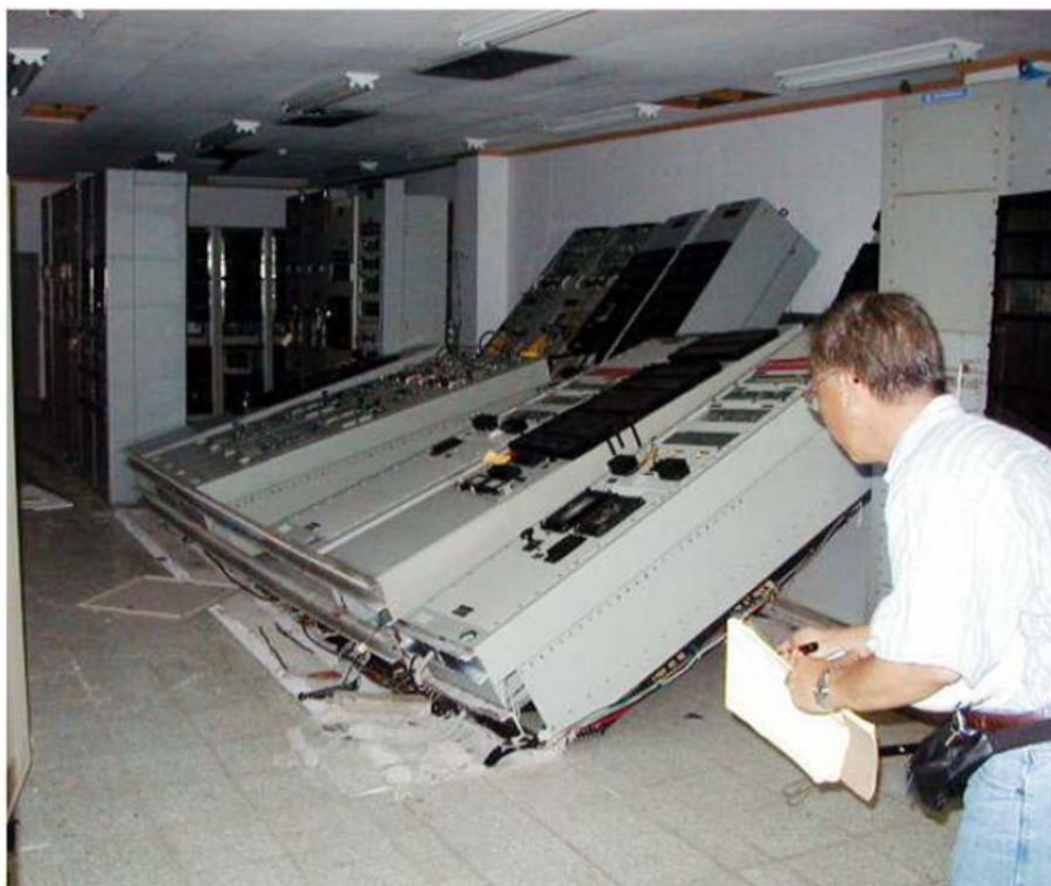
شکل پ ۲-۲۱- خرابی و واژگونی پانل‌ها در زلزله ۱۹۸۵ مکزیکوسیتی با بزرگای ۸
