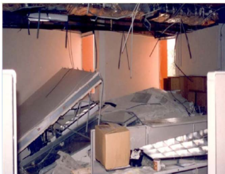
شکل پ ۳-۲- خرابی پارتیشن‌های اداری، سقف‌ها و چراغ‌های سقف در زلزله نورث ریج ۱۹۹۴
