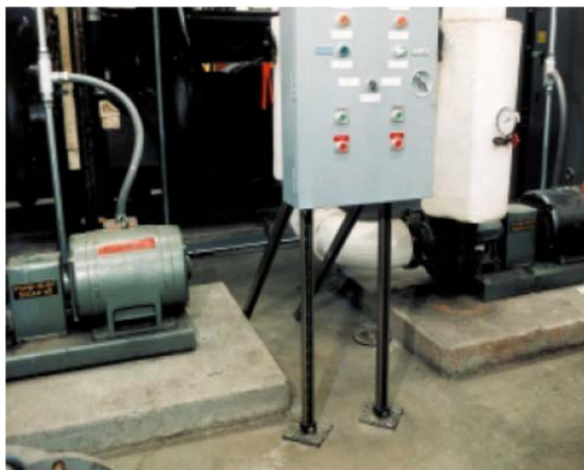
شکل ۵-۱۵۰- اتصال کنترل پانل با مهار (مهار به این شکل کافی نیست)
