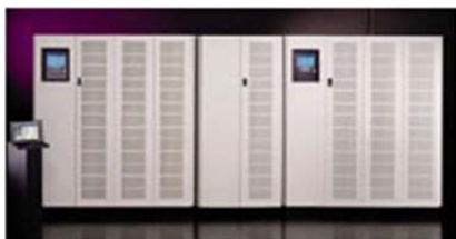
شکل ۱-۱۳۶-UPS (نصب شده بر روی کف)
