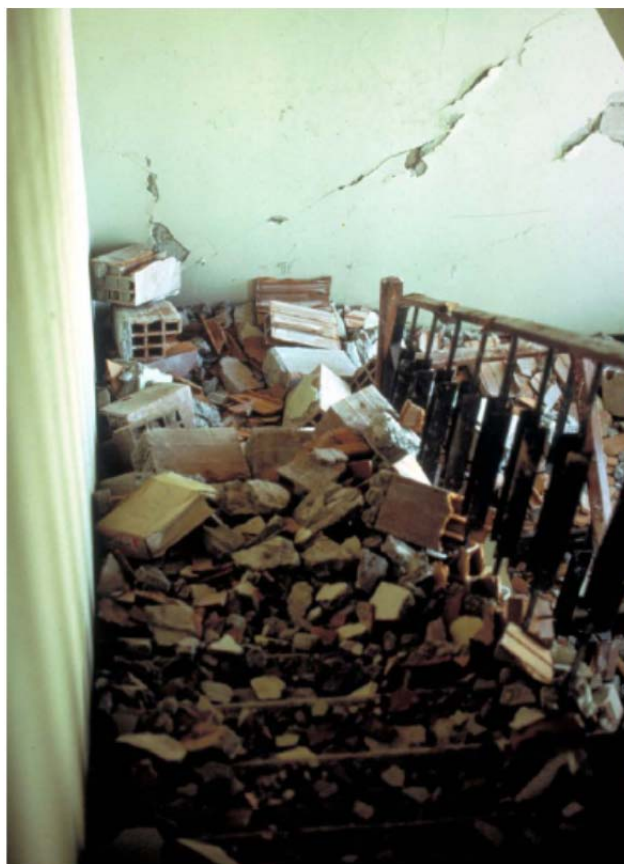
شکل پ ۲-۶- نمونه‌ای از پوشیده شدن راه‌پله‌ها از تکه‌ها و قطعات ناشی از خرابی پارتیشن‌های اطراف راه‌پله که باعث غیرقابل استفاده شدن راه‌پله پس از زلزله گردید (زلزله ۱۹۷۲ نیکاراگوا- بزرگا ۶/۲)
