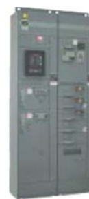
شکل ۱-۱۲۱- مرکز کنترل اندازه‌گیری ولتاژ پائین (نصب شده بر روی کف)
