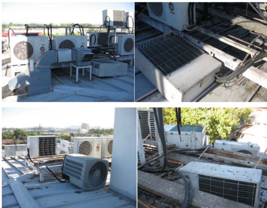
شکل پ ۲-۱۳- افتادن و خرابی تعداد زیادی از تجهیزات واقع بر سقف به علت مهار نامناسب در زلزله ۲۰۱۰ شیلی
