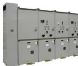
شکل ۱-۱۱۳- صفحه کلید ولتاژ متوسط (نصب شده بر روی کف)
