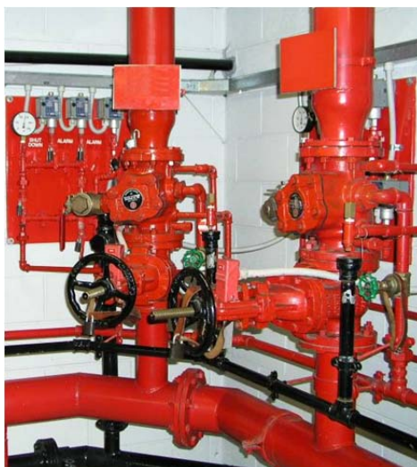
شکل ۱-۸۴- سیستم اطفاء حریق شامل لوله‌ها و کلیدهای فشار و شیرهای مونیتورینگ
