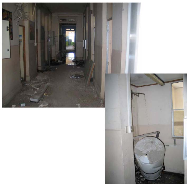
شکل پ ۲-۱۹- آسیب دیدگی مخازن آب در بیمارستان talca در زلزله ۲۰۱۰ شیلی. آب در سطح بیمارستان از مخازن پخش شده بود. این بیمارستان به علت آسیب‌های وارده به اجزاء غیرسازه‌ای که یکی از اصلی‌ترین آنها آسیب ناشی از آب بود با وجود سالم ماندن خود بیمارستان برای مدت قابل توجهی بعد از زلزله تعطیل بود.
