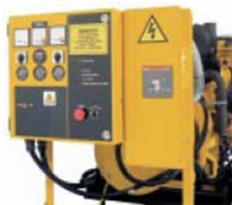
شکل ۱-۹۲- دستگاه کنترل ژنراتور (نصب شده بر روی تجهیزات)
