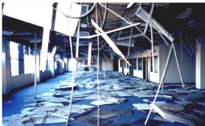
شکل پ ۲-۴- خرابی و فروریزش سقف کاذب و چراغ‌های سقفی در زلزله ۱۹۹۴ نورث ریج
