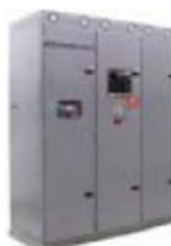
شکل ۱-۱۰۹- تابلوهای برق (نصب شده بر روی کف)
