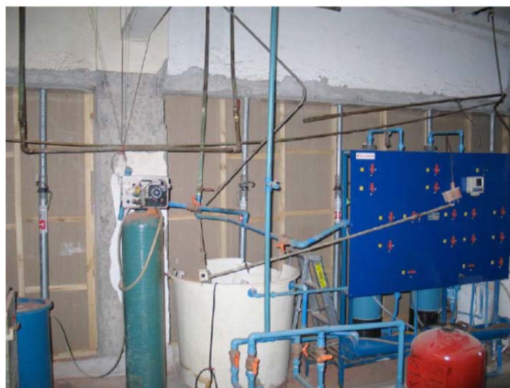
شکل پ ۲-۷- خرابی دیوار میان قابی آجری و افتادن آن بر روی دو مخزن آب ۶۰۰ لیتری آب شد که باعث ورود آب به ۳ تا از ۶ اتاق عمل بیمارستان واقع در شیلی شد و از مدار خارج شدن آنها گردید (زلزله ۲۰۱۰ شیلی)
